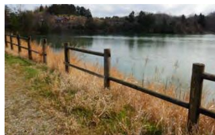
安全柵の破損状況
