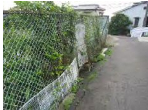
金網による応急措置の状況
