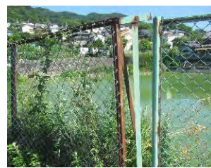
安全柵の破損状況
