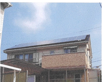
# 489 太陽光パネル
