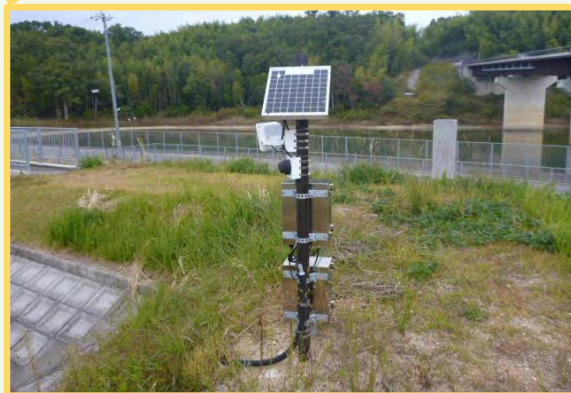
▲ ICT機器（水位計、カメラ）の設置状況
