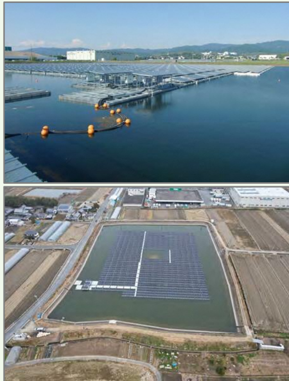
▲水上太陽光発電設備の設置状況
