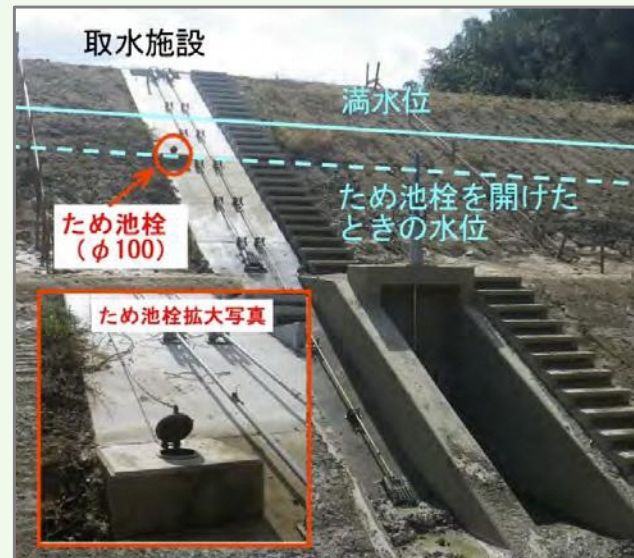
▲ため池栓の整備状況
