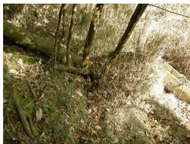
木の根部分から、漏水が発生
