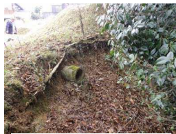
能力不足(排水管)
