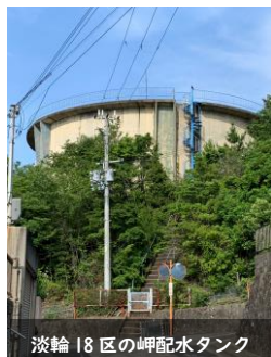
淡輪18区の岬配水タンク
