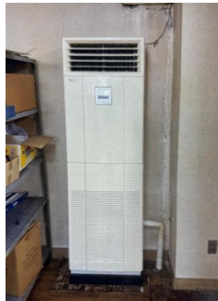
故障した空調機
