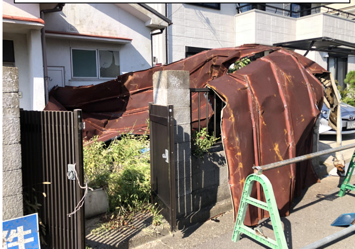
2018.9.5 台風21号により 屋根がすべて飛散
