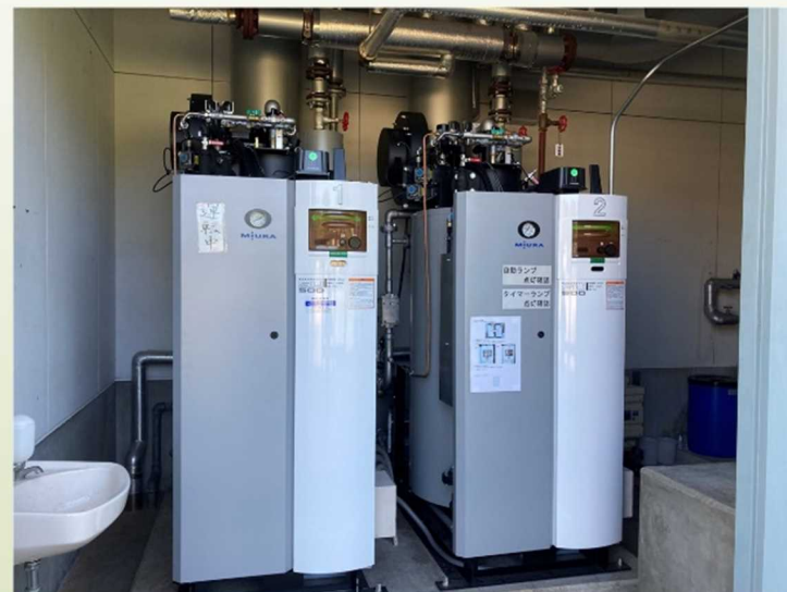
⑥ 給食センター整備事業 （蒸気ボイラ購入） 10,450千円
